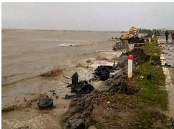
Hình 9. Hình ảnh sạt lở đê biển Tây Cà Mau trong đợt triều cường cao vào đầu tháng 8/2019
